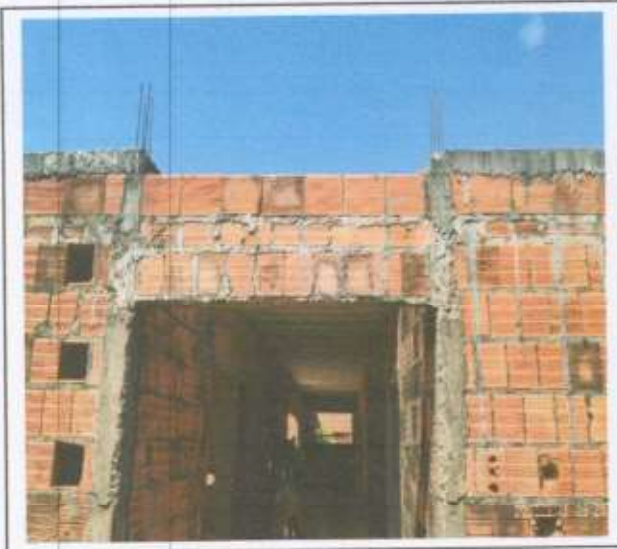
Armaduras exposta com baixa oxidação.
